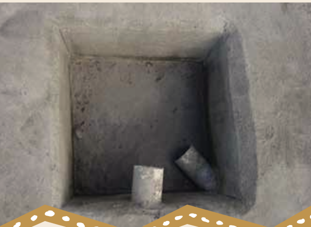
Foto 24 – Detalhe do decantador
