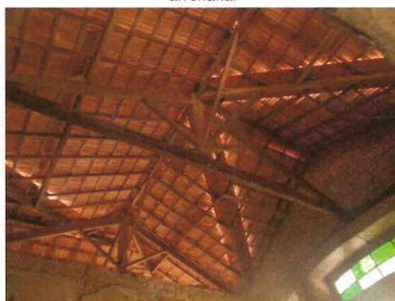
Vista parcial do segundo pavimento. Remoção da laje de forro do segundo pavimento. Restauração do telhado em telha francesa e da estrutura de suporte. Detalhe para reforço na estrutura em madeira na empena.
