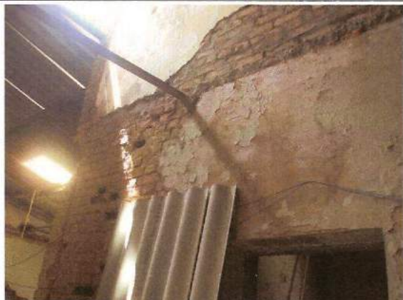
Vista parcial do segundo pavimento. Tratamento das principais trincas e recomposição da alvenaria.
